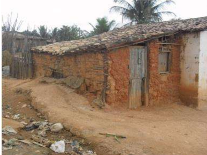
Figura 3 - Falta de preocupação com a fundação
