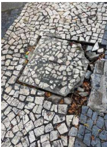
Figura 10 - Tapa de caixa de inspeção danificada
